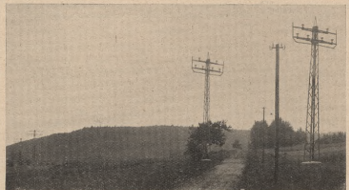
Abb. 4. Hochspannungsstrecke für 50 000 Volt. Stützisolatoren und eiserne Gittermaste in Anordnung auf unebenem, hügeligen Gelände bei einer Wegekreuzung
