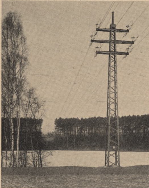
Abb. 5. Hochspannungsstrecke des Märkischen E. W., eine 40 000 Volt-Überspannung des Trebuser Sees. Um die Gefährdung der Leitungen durch umstürzende Bäume auszuschließen, ist der Wald zu beiden Seiten der Leitungen ausgeholzt
