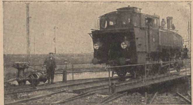
Abb. 6. Drehscheibe mit Antrieb durch einen Einphasen-Kollektor-Motor von 15 PS, 0—1100 Umdr.-Min., 240 Volt, 45,3 Perioden, auf dem neuen Ostbahnhof in Frankfurt a. M.
