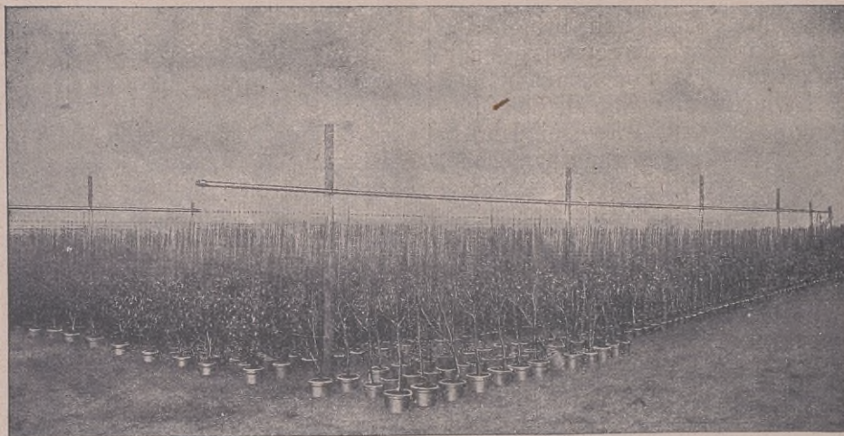
Abb. 4. Selbsttätige Beregnungsanlage in einer Baumschule
