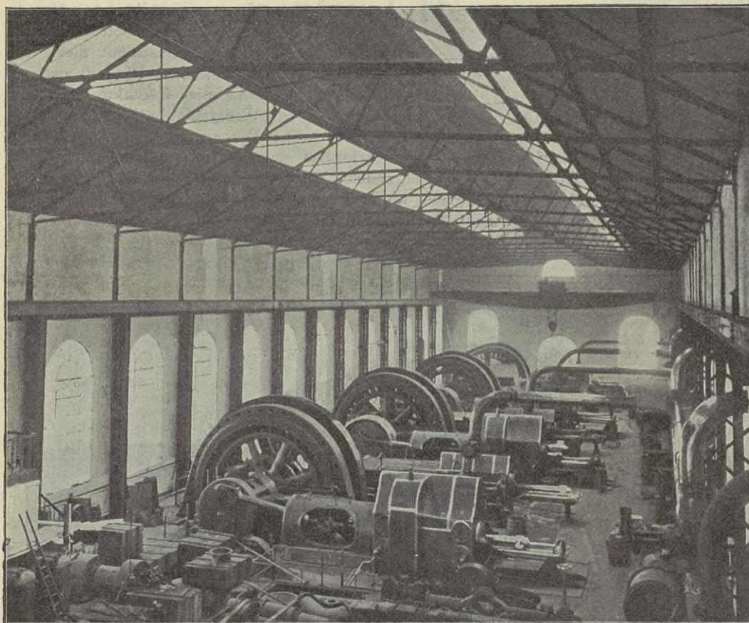
Fig. 1. Inneres der Zentrale in Formby.
