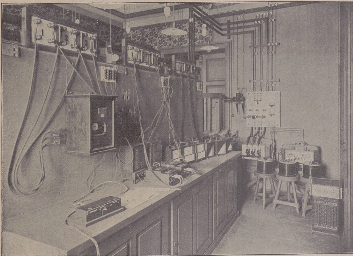
Fig. 7. Wechsel- und Drehstrom-Meßzimmer.
