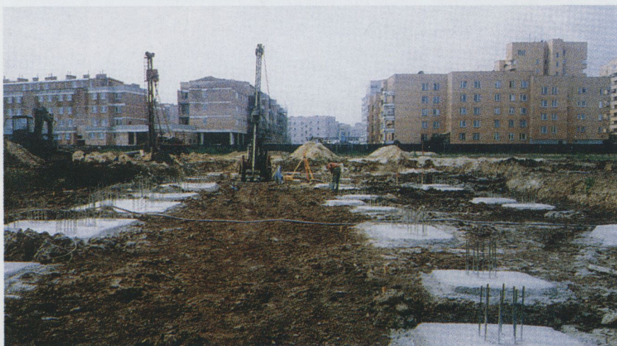
Pale „jet grouting” o średnicy \phi 600 mm pod nowo wznoszone budynki na osiedlu Wilga VII w Warszawie
