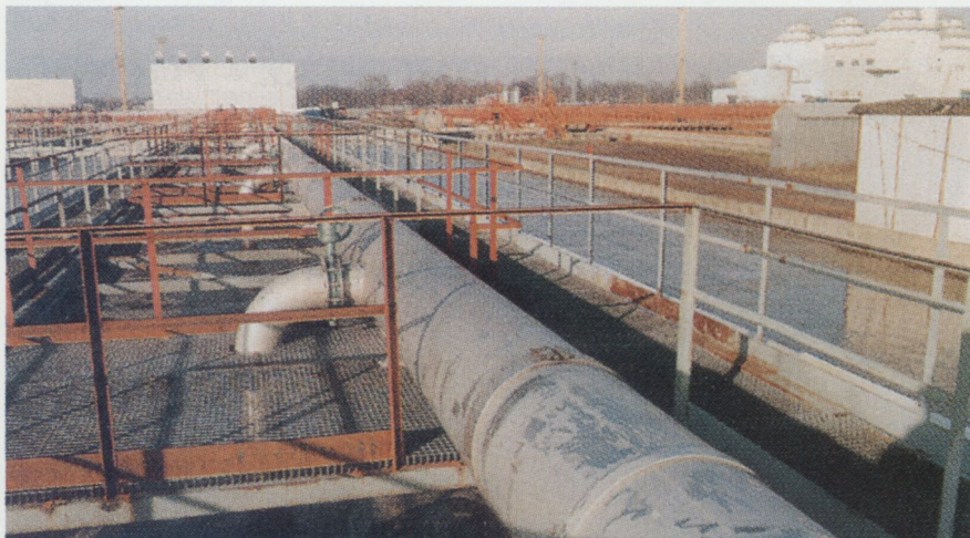
Rurociągi oczyszczalni ścieków „Czajka”, Warszawa
