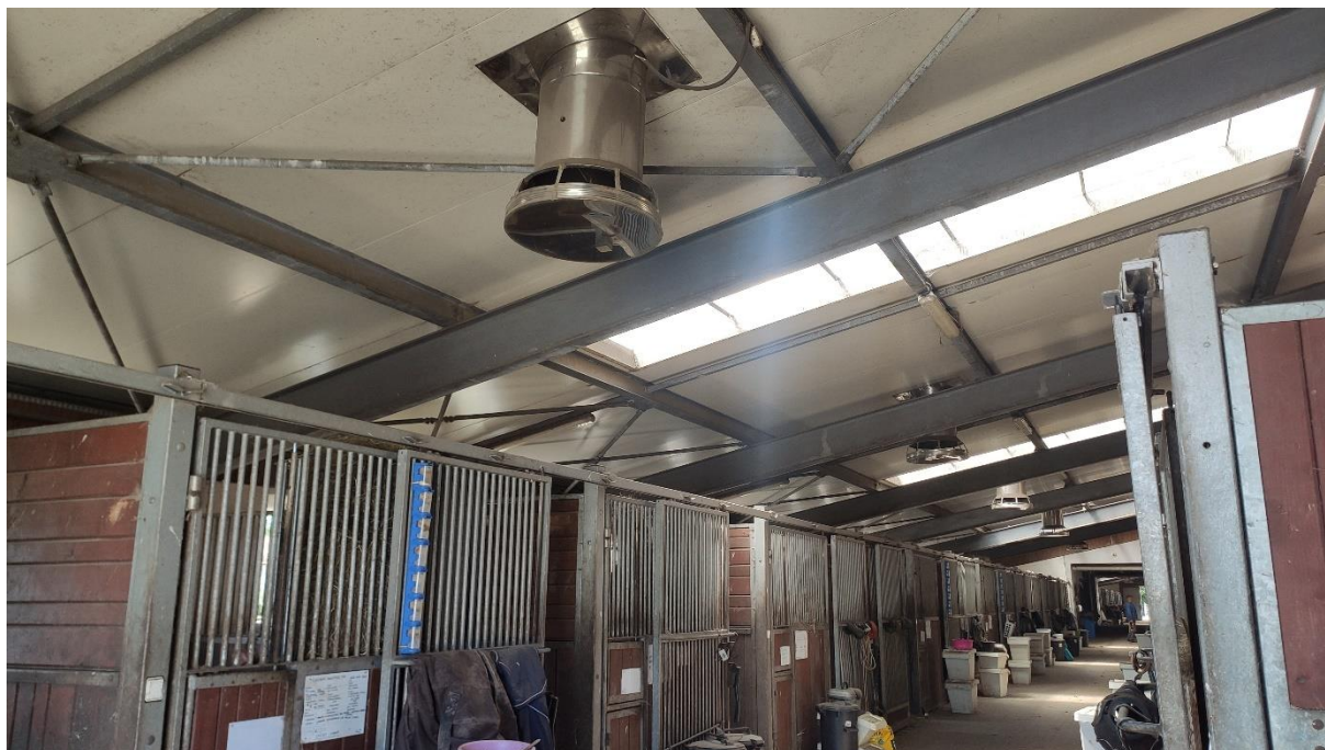
Rycina 3.5 Wentylacja mechaniczna w ośrodku jeździeckim w Facimiechu. Fot. A. Kuśmierska, 2023
