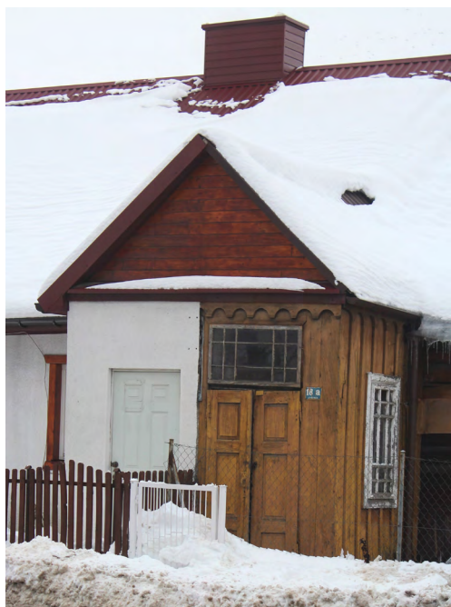
Il. 17. Ul. Piłsudskiego 18. Przykład bliźniaczego wejścia do ganku szeroko-frontowego domu. Po prawej widoczne historyczne drzwi z nadświetlem, po lewej wstawione nowe drzwi typowe, zupełnie niedobre wymiarami do otworu oryginalnego. Lewa część budynku pokryta tynkiem, pod którym znikły drewniane ozdobne listwowania podszczytowe ganku. Fot. E. Sroczyńska, 2023.
