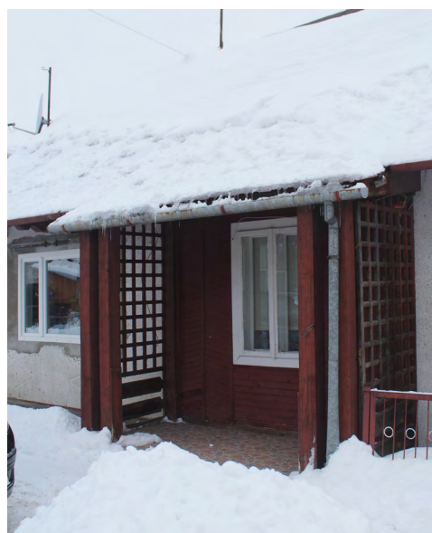
Il. 27. Ul. Podzamecze 19. Termomodernizacja budynku przyniosła wiele dodatkowych zmian. Obok wymiany okien na dwudzielne, niesymetryczne (takich nigdy nie było w budynkach historycznych), zreorganizowano wejście do budynku, przenosząc je na stronę dziedzińca, co pociągnęło wmontowanie w miejsce dawnych drzwi dwudzielnego okna. Wprawdzie zdwojone słupy dawnego otwartego ganku zostały, jednak zlikwidowano jego trójkątny szczyt, zamieniony na jednospadowy daszek. Fot. E. Sroczyńska, 2023.
