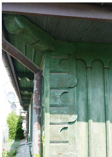
Il. 31. Naroże budynku imitujące boniowania w budynkach murowanych. Widoczny narożny, ukośnie ustawiony element konstrukcyjny tzw. „ryś”. Fot. J. Łaś, 2023.
