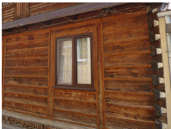
Il. 4. Budynek „A” Sposób łączenia dwóch typów konstrukcji: naroże w konstrukcji zrębowej, pozostała część ściany w konstrukcji sumikowo-łątkowej. Fot. J. Łaś, 2023.
