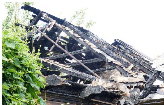
Il. 22. Budynek mieszkalny po pożarze z widoczną prostą konstrukcją dachu – krokwiowo-jętkową. Fot. J. Łaś, 2023.
