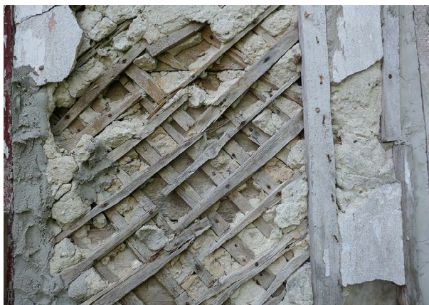
Il. 10. Umocnienie konstrukcji ścian – drewniany ruszt z listewek, w układzie kratowym, wypełniony zaprawą wapienną (lub zaprawą glinianą zmieszaną z sieczką słomianą). Fot. J. Łaś, 2023.
