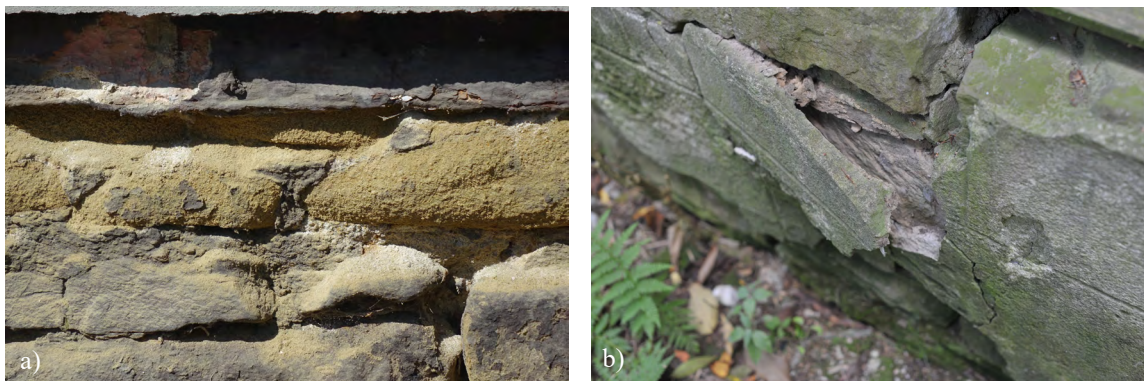
Il. 15: a) Pokrycie kamiennego muru fundamentowego bitumem, widoczna korozja kamienia; b) Uszkodzenia muru fundamentowego kamiennego na skutek pokrycia zaprawą cementową. Fot. P. Horodyski.
