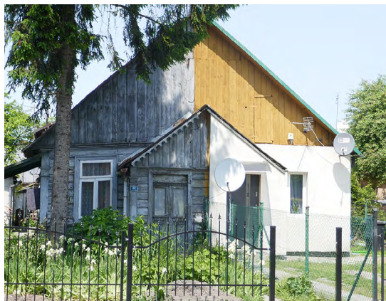
Il. 38. Nieudolny sposób remontowania starych budynków drewnianych, który w tym wypadku pokazuje, że podział własnościowy jest wartością nadrzędną dla mieszkańców. Fot. J. Łaś, 2023.
