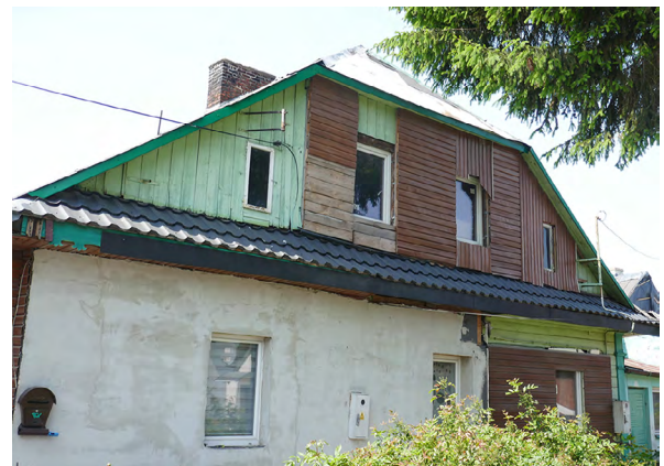
Il. 39. Nieudolny sposób remontowania starych budynków drewnianych, prowadzący nieuchronnie do utraty ich wartości wizualnych. Fot. J. Łaś, 2023.
