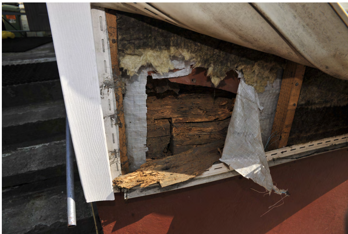
Il. 11. Uszkodzenia drewna budynku pod sidingiem z wełną mineralną. Fot. Piotr Horodyski.
