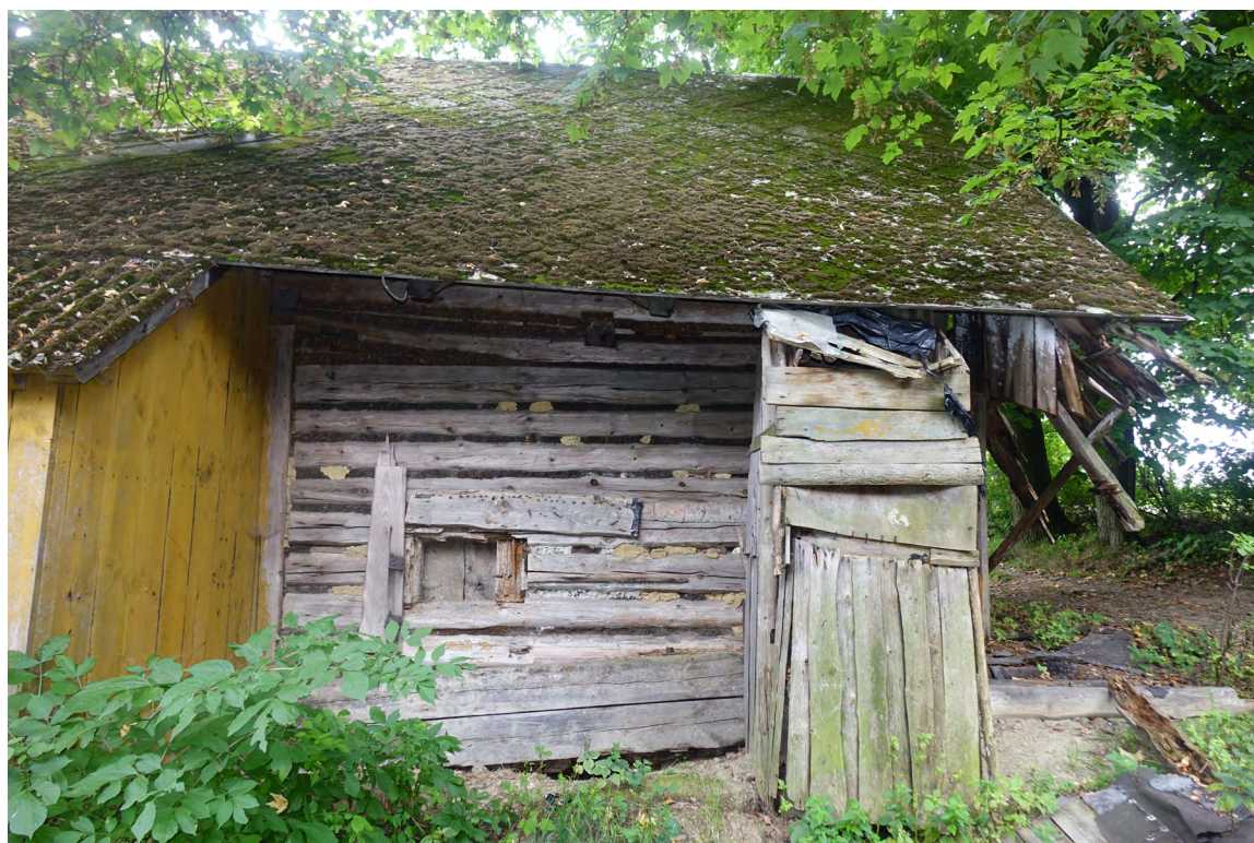
Il. 17. Utrata stabilności ściany drewnianej w wyniku uszkodzenia fundamentu. Fot. P. Horodyski.
