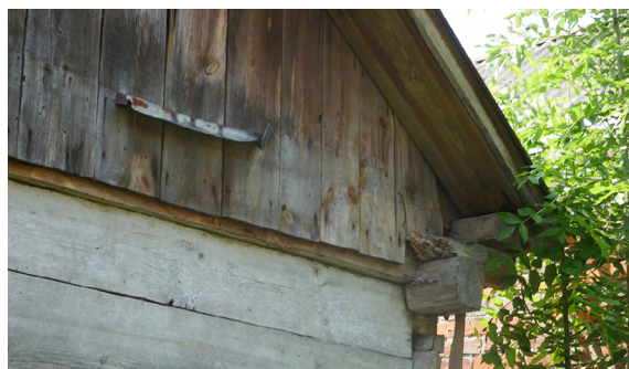
Il. 20. Budynek gospodarczy. Resztki konstrukcji pod nieistniejącą już strzeszkę. Fot. J. Łaś, 2023.
