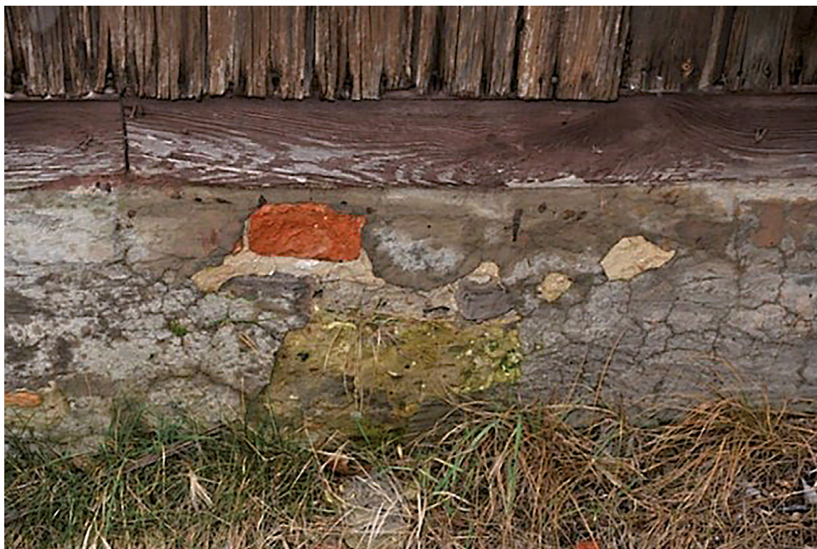
Il. 16. Wysolenia na murze fundamentowym kamiennym pokrytym wraz z „rolką” silną zaprawą cementową, widoczne są uszkodzenia cegły „rolki”. Fot. P. Horodyski.
