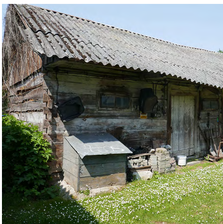
Il. 8. Budynek gospodarczy w konstrukcji mieszanej. Ściany nieotynkowane, belka oczepowa i podwalinowa zlicowane z linią ścian zewnętrznych. Fot. J. Łaś, 2023.
