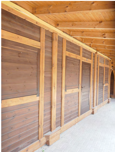
Il. 34. Budynek współczesny, usługowo-handlowy (kramy) z wyeksponowaną konstrukcją sumikowo-łatkową. Fot. J. Łaś, 2023.
