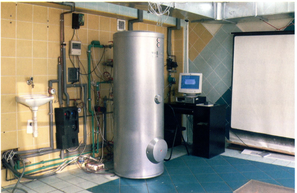
Laboratorium energii odnawialnych – zasobnik ciepła systemu solarnego z wyposażeniem pomiarowym
