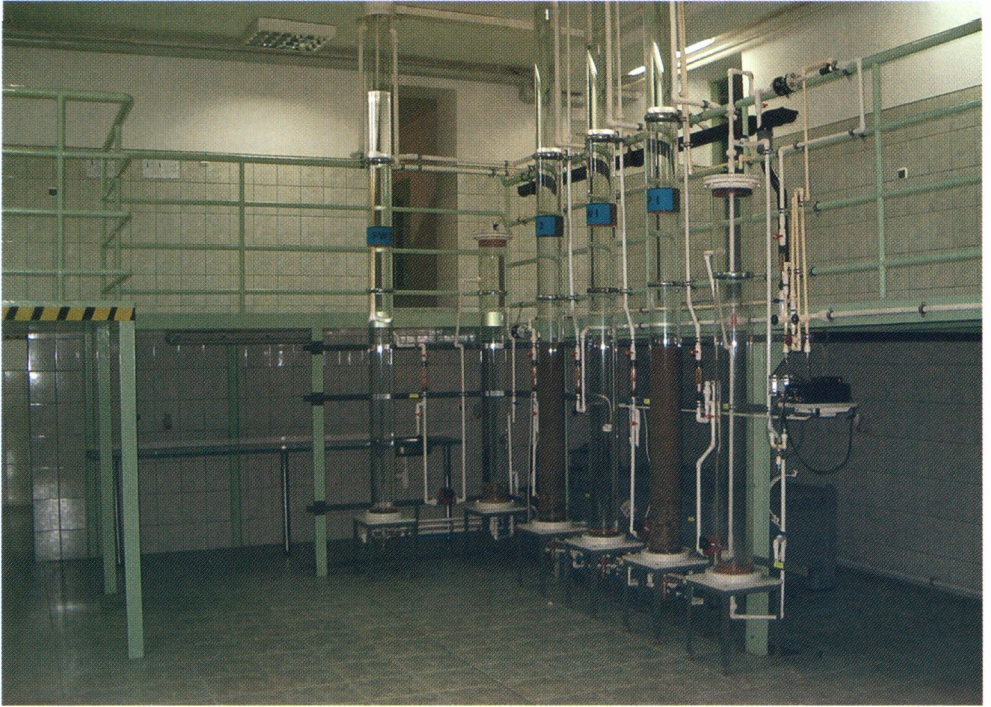
Stacja pilotowa ozonowania i adsorpcji na węglu aktywnym w Zakładzie Uzdatniania Wody Rudawa
