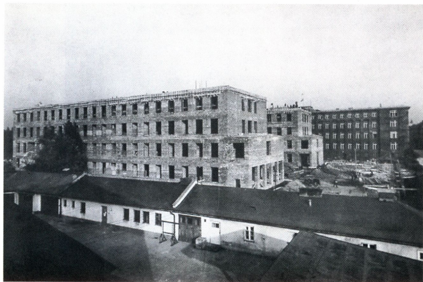
19. Budowa pawilonów laboratoryjnych A1 i A2 Akademii Górniczo-Hutniczej przy ul. Reymonta – październik 1949
