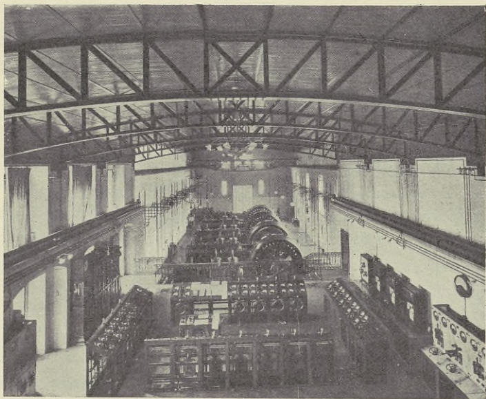
Impianto Crespi. — Interno della Centrale.
