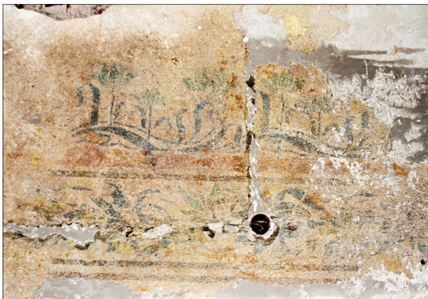
Ryc. 10. Próby użycia szablonów do wykonania fryzów z czasu budowy ok. 1903, odkryte w 2015 na ścianie pokoju na I piętrze budynku E-5; fot. A. Witkowska.
