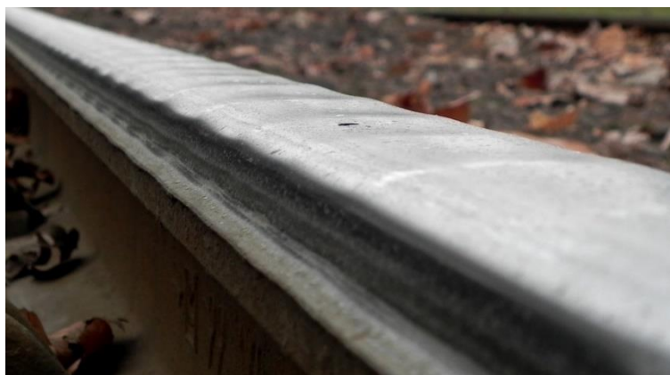
Rys. 2.31. Przykład zużycia falistego powstałego na powierzchni główki szyny kolejowej [źródło własne]
