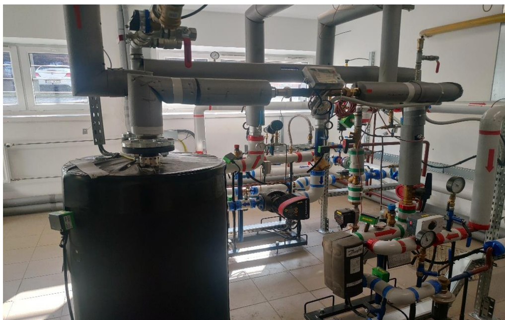
Rys. 9.1 Badany węzeł cieplny Miejskiego Przedsiębiorstwa Energetyki Ciepłej w Krakowie.
