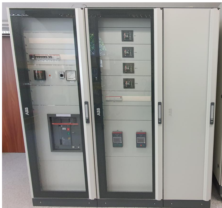
Rys. 60. Rozdzielnica dwusegmentowa nn z polem zasilającym oraz odbiorowym [opracowanie własne]
