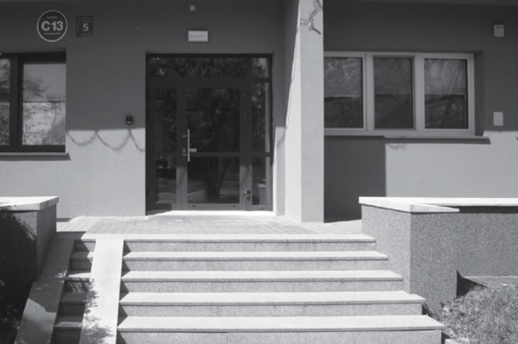
II. 4. Wejście do domu studenckiego II – al. Politechniki 5 Łódź. Widok schodów prowadzących do wejścia głównego wraz z nieergonomicznym podjazdem. autor: R. Przewłocka-Sionek
