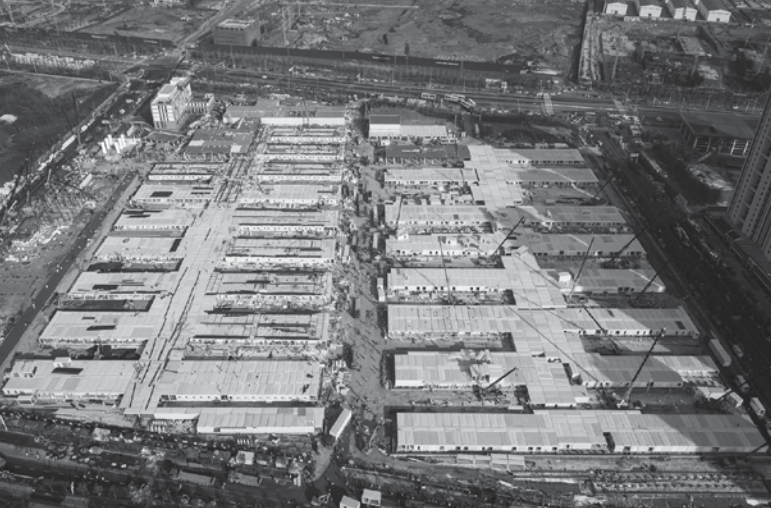
Il. 4. Zdjęcie lotnicze przedstawiające budowę Szpitala Leishenshan w Wuhan, 4 lutego 2020 roku. http://www.xinhuanet.com/english/2020-02/05/c_138756336_10.htm (dostęp: 30.10.2024)
