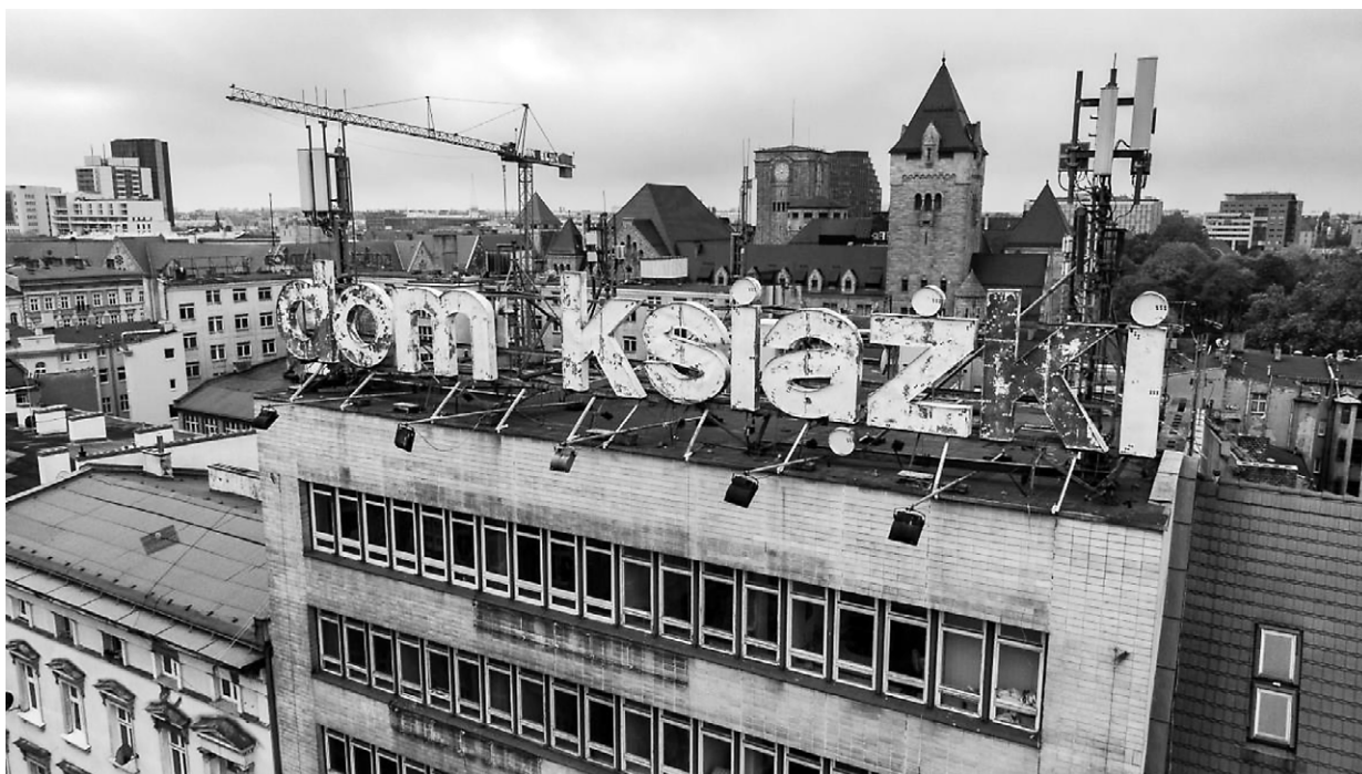
Ryc. 8. Konstrukcja i neon „Dom Książki” na dachu budynku, widoczne ubytki elementów reklamowych w niższej części elewacji, 2023; fot. Constructa Plus
