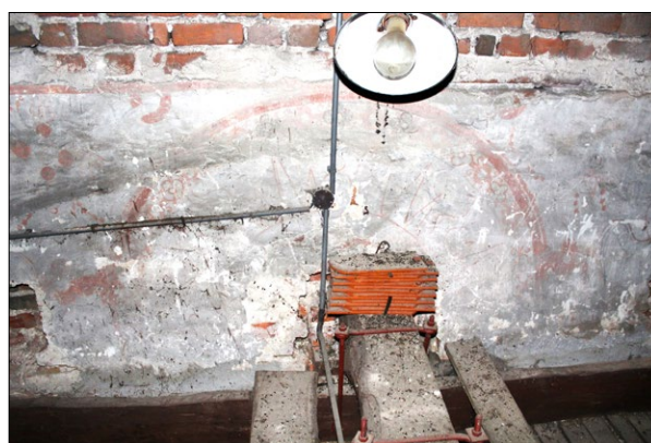
Ryc. 9. Kościół parafialny w Rychwale, detal środkowej części malowidła na zachodniej ścianie szczytowej (gloria promienista)
