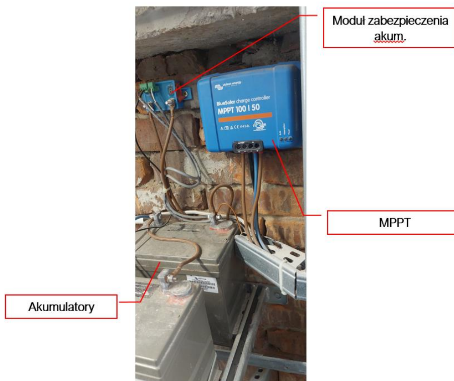
Rys. 15.6. Elementy układu zasilania OFF-Grid; moduł zabezpieczenia akumulatorów – Victron Energy SBP 65, MPPT – Victron Energy MPPT 100/50, akumulatory – Victron Energy BAT04 12V 60Ah
