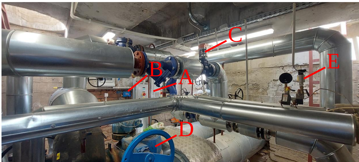
Rys. 15. Komora OFF-Grid po modernizacji: A - szafy elektryczne, B - MPPT, C - zawory z siłownikami, D - przepustnice, E - przetworniki ciśnienia
