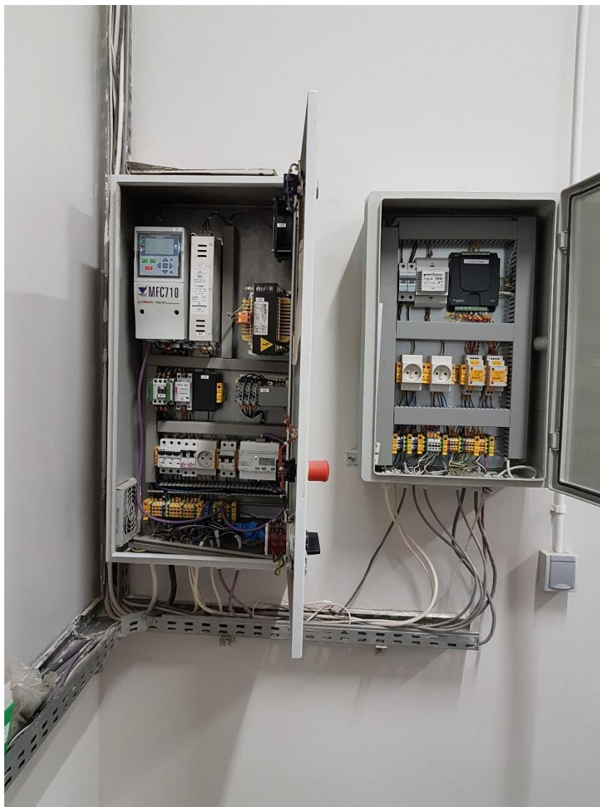
Rys. 13.10. Widok szaf sterowniczych dla układu turbina – generator dla instalacji w systemie ON – Grid - obiekt 2
