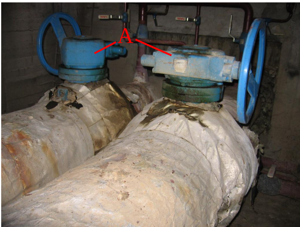
Rys. 2. Komora OFF-Grid przed modernizacją: A- przepustnice
