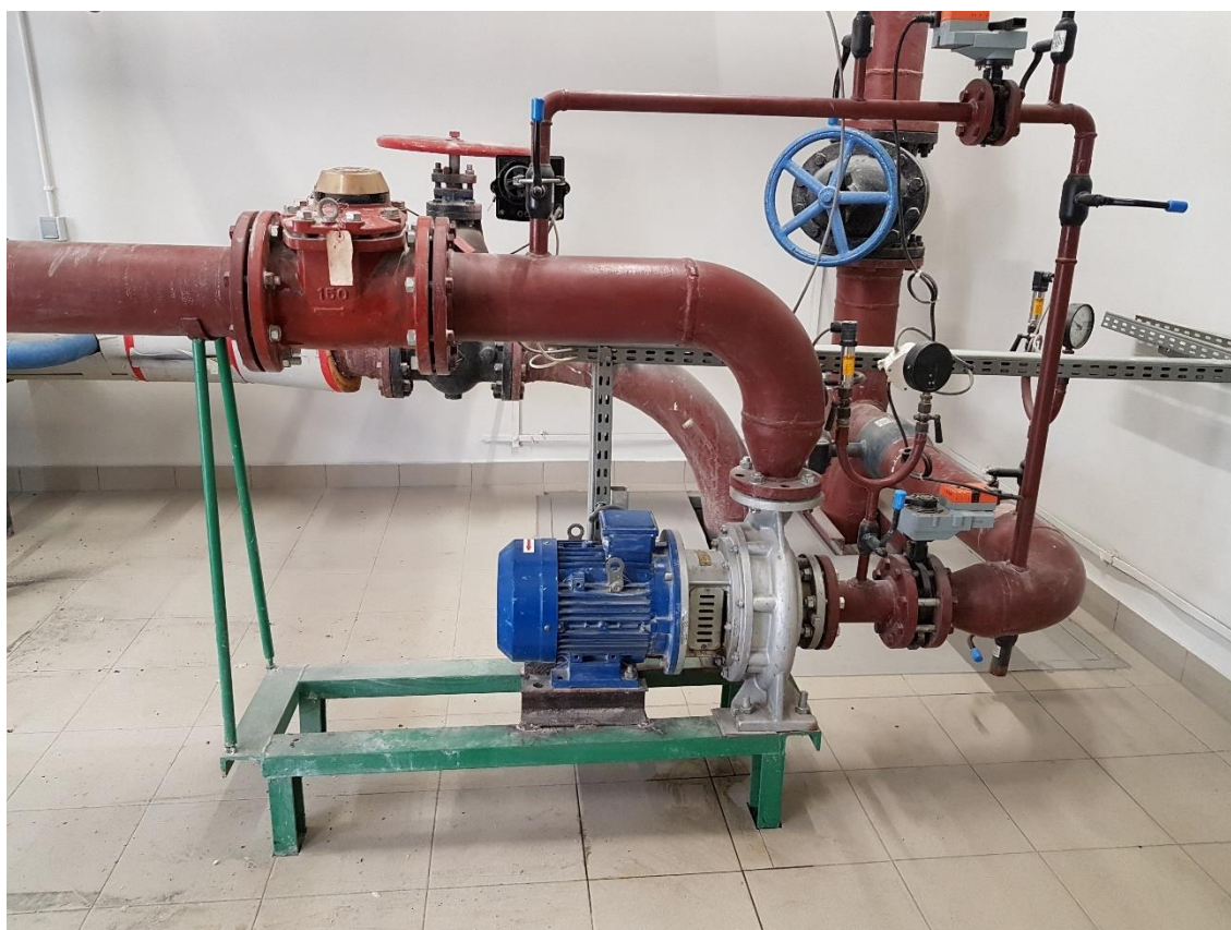
Rys. 13.9 .Widok fragmentu instalacji ciepłowniczej w systemie zasilania ON – Grid - obiekt 2
