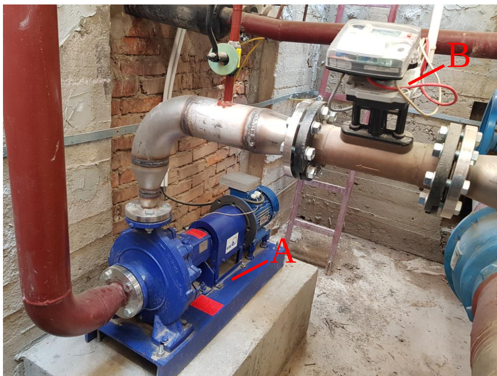
Rys. 6. Komora OFF-Grid po modernizacji: A -zespół turbina – generator, B - licznik ciepła
