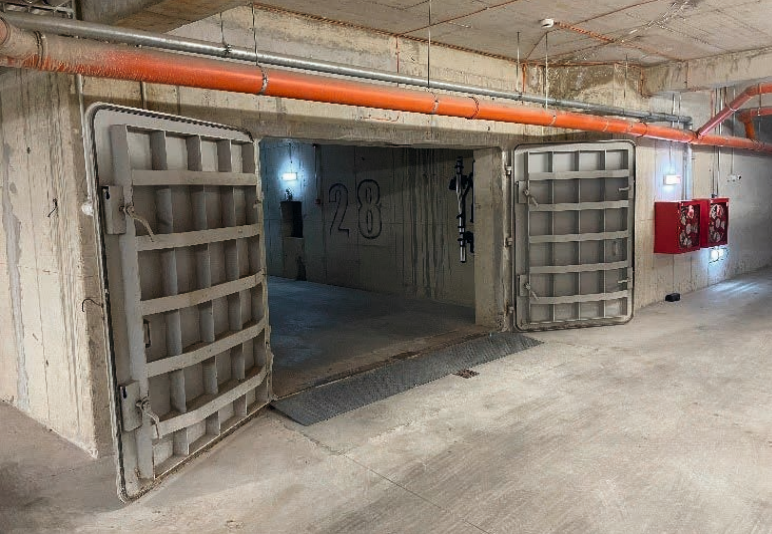
II. 3. Specjalne drzwi ochronne w garażu podziemnym w budynku mieszkalnym w Rumunii. Foto: M. Dmitruk
