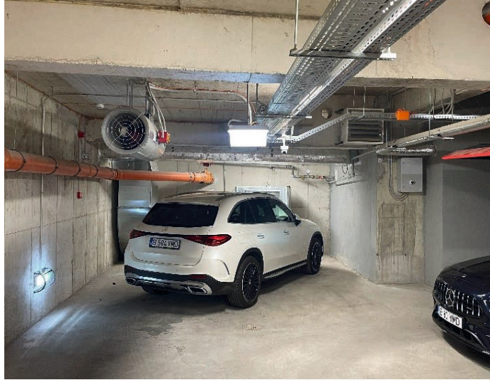
II. 4. Instalacje wentylacyjne wewnątrz garażu podziemnego w budynku mieszkalnym w Rumunii. Foto: M. Dmitruk
