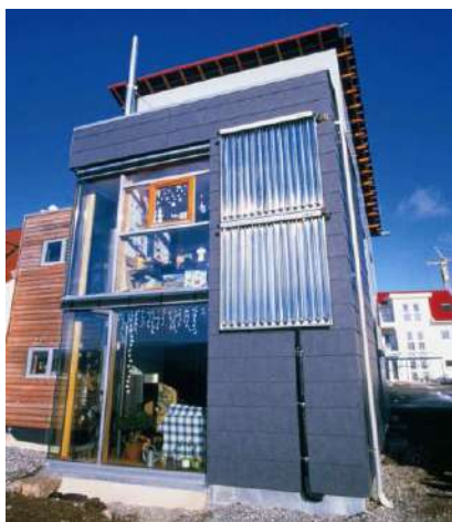
Il.144a. Kolektory próżniowo-rurowe na fasadzie obiektu (źródło zdjęcia wg. przypisu 169 )
