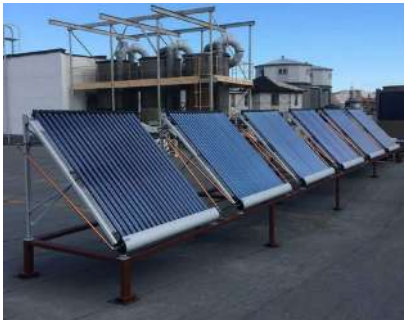
II.135d. Kolektory próżniowo-rurowe na dachu płaskim (źródło zdjęcia: Schweizer)
