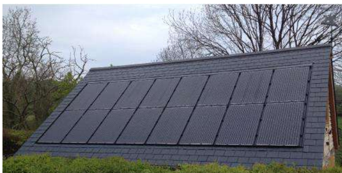
Il.142a. Instalacja solarna bezramkowa (źródło zdjęcia wg. przypisu 163 )
