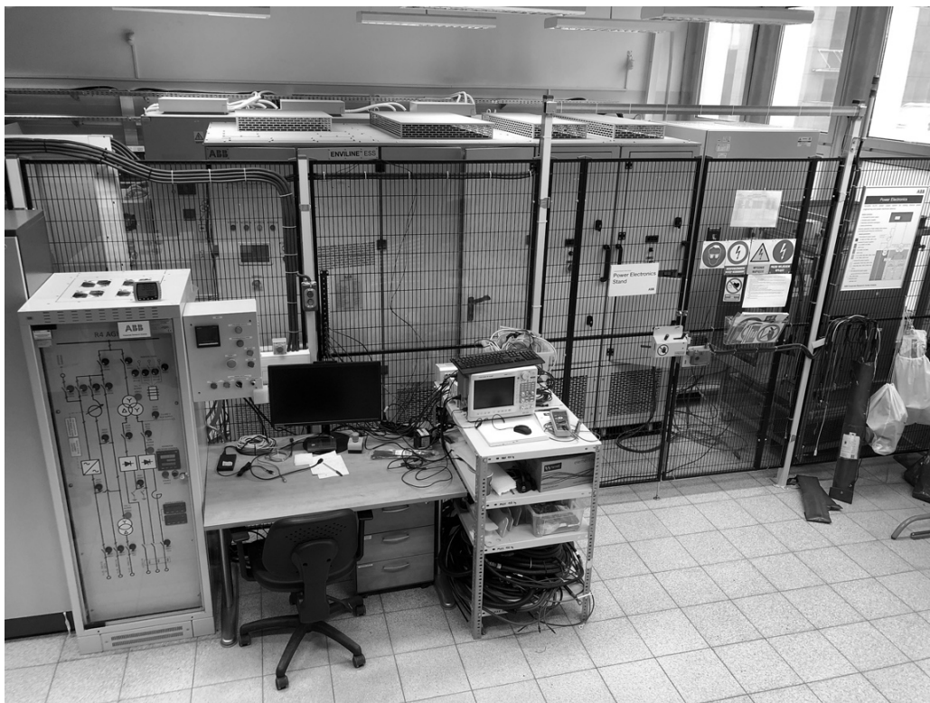
Rysunek 4-37 Stanowisko testowe rzeczywistego układu konwertera FSBB z dwoma magazynami superkondensatorowymi (źródło: archiwum własne za zgodą podmiotu zatrudniającego).
