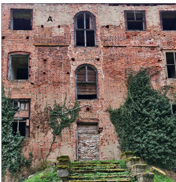
Ryc. 7. Środkowa część elewacji wschodniej; linią przerywaną oznaczono strefę zaburzenia wstępu gotyckiego; A – zablockowane okno z fazy III, 2024; fot. K. Wroński
