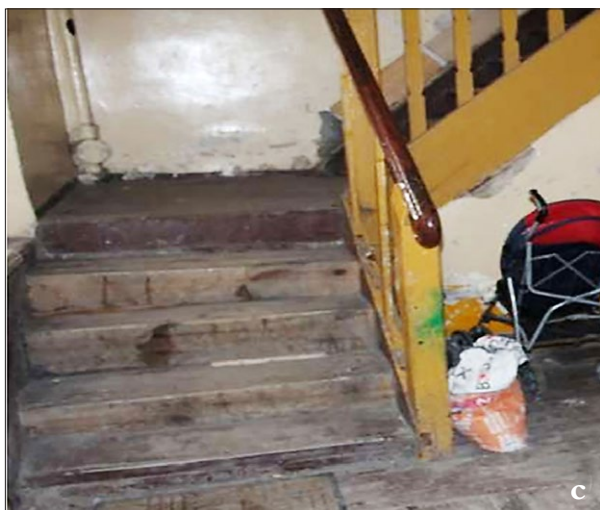
Ryc. 4. Stan zachowania elementów budowlanych obiektu w 2017 r.: a) więźba dachowa z widocznymi śladami zawilgocenia elementów konstrukcyjnych oraz uzupełnieniami pokrycia dachowego wykonanymi z arkuszy papy, b) pomieszczenie wewnątrz kamienicy z oznakami zawilgocenia ścian oraz uszkodzeniem sufitu, c) sień główna z zachowaną drewnianą klatką schodową
