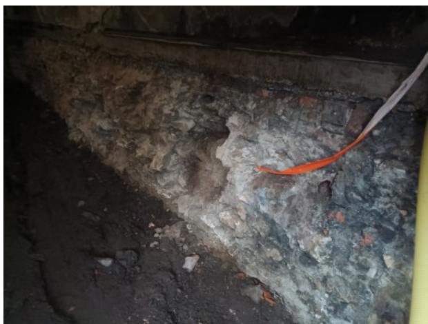
Il. 4. Fragment ściany przeznaczonej do naprawy, 2025. Fot. aut.
