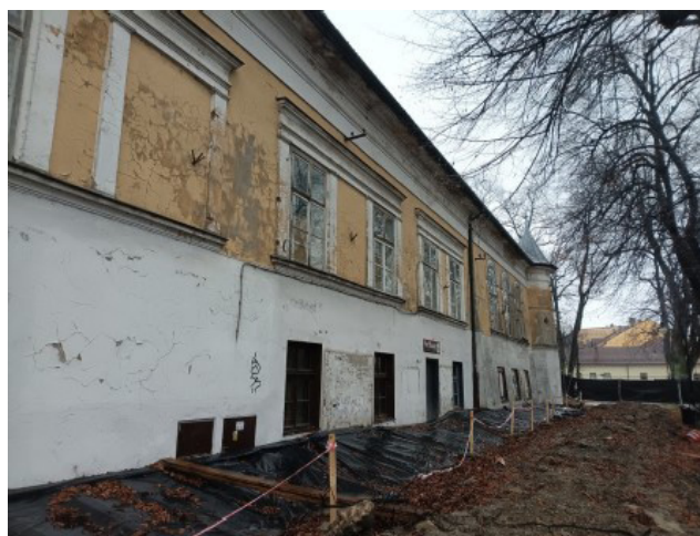
Il. 6. Nieprawidłowe zabezpieczenie wykopu folią – niektóre odcinki przerwane – woda opadowa dostaje się do wykopu. Brak etapowania – wykop ciągły, 2025. Fot. aut.
