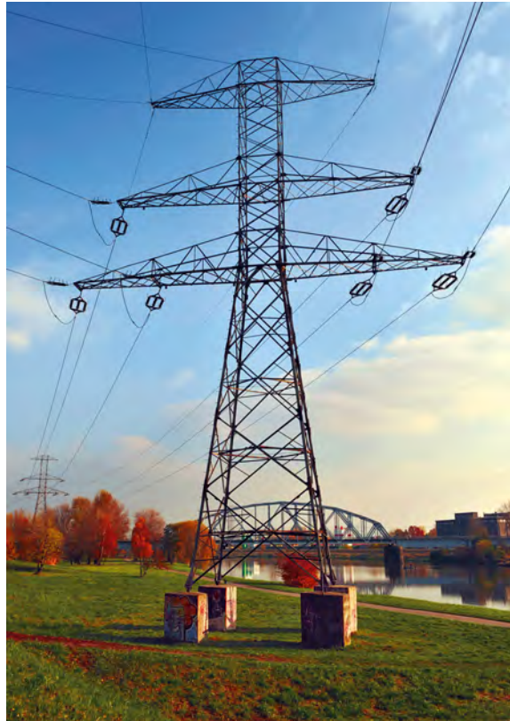
Maszt napowietrznych linii elektroenergetycznych — element infrastruktury krytycznej
