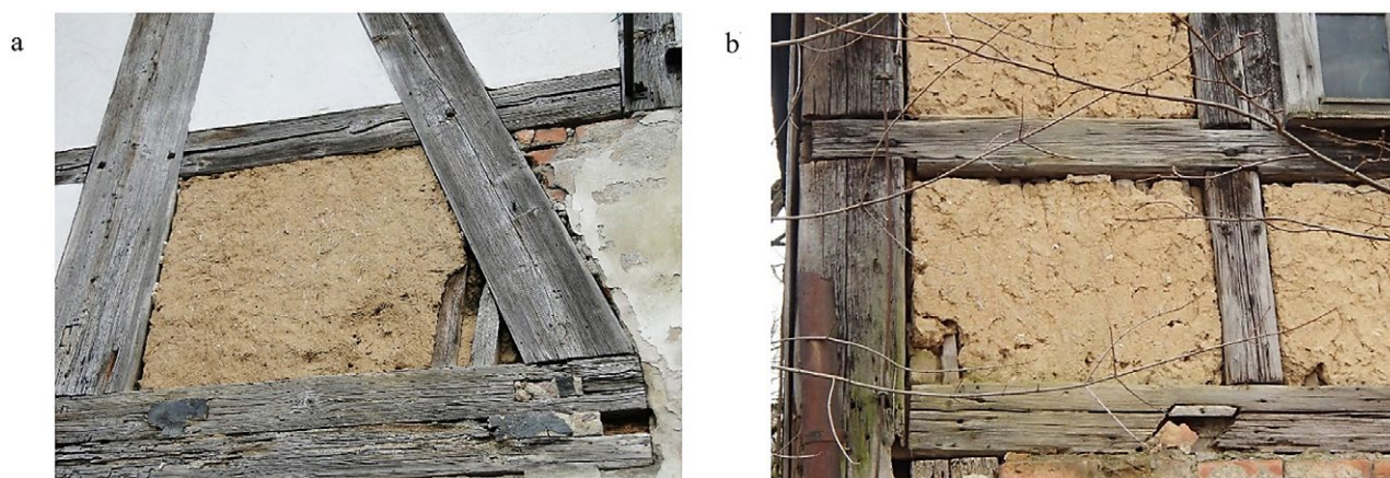
Ryc. 5. Przykład zniszczenia tynku na wypełnieniu ściany szachulcowej Fig. 5. An example of plaster damage on the infill of a half-timbered wall
