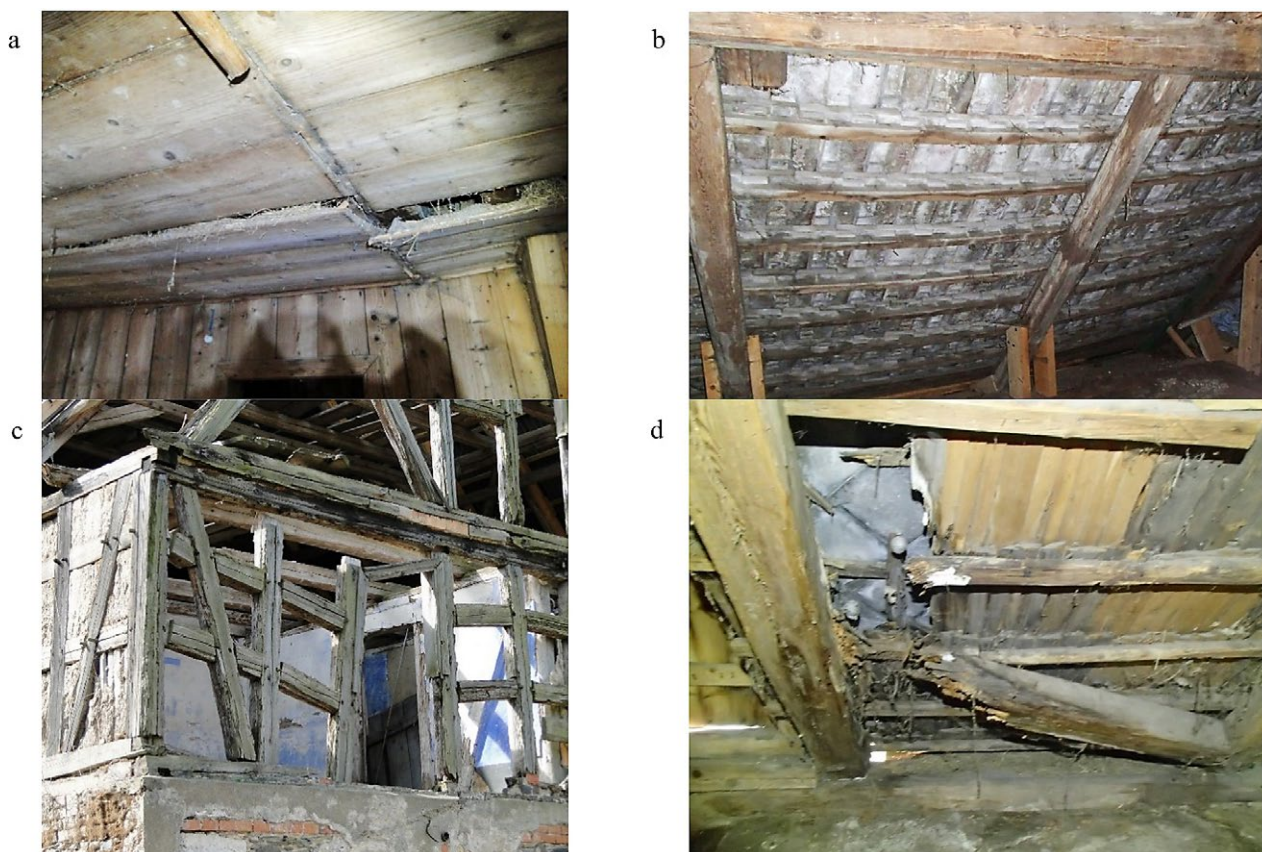
Ryc. 9. Przykłady: a–b) nadmiernej deformacji elementów konstrukcyjnych, c–d) zniszczenia elementów konstrukcyjnych Fig. 9. Examples: a–b) of excessive deformation of structural elements, c–d) of damage to structural elements
