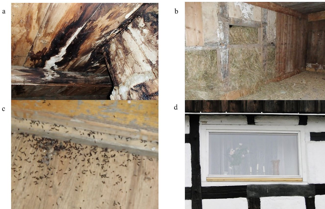
Ryc. 8. Przykłady: a) niewłaściwego długotrwałego użytkowania pomieszczeń – kumulowania wilgoci, b) braku bieżących napraw, c) niewłaściwych napraw, d) bytności drewnojadów
