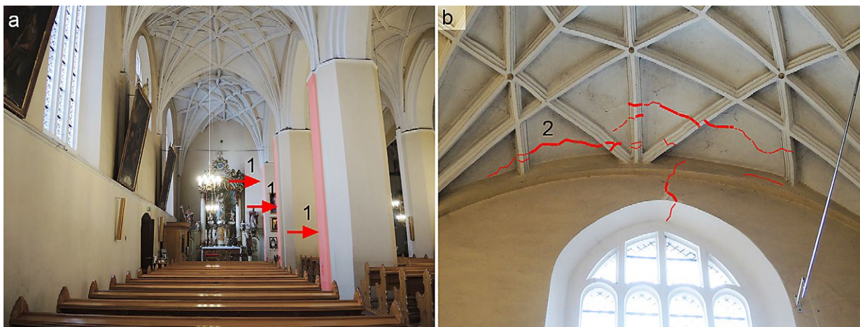
Ryc. 2. Kościół w Świebodzinie: a) wnętrze nawy północnej z oznaczeniem śladów po pierwotnych przyporach (1); b) spękanie strefy podporowej sklepienia gwiaździstego (2) oraz strefy nadproża łukowego; 2022
