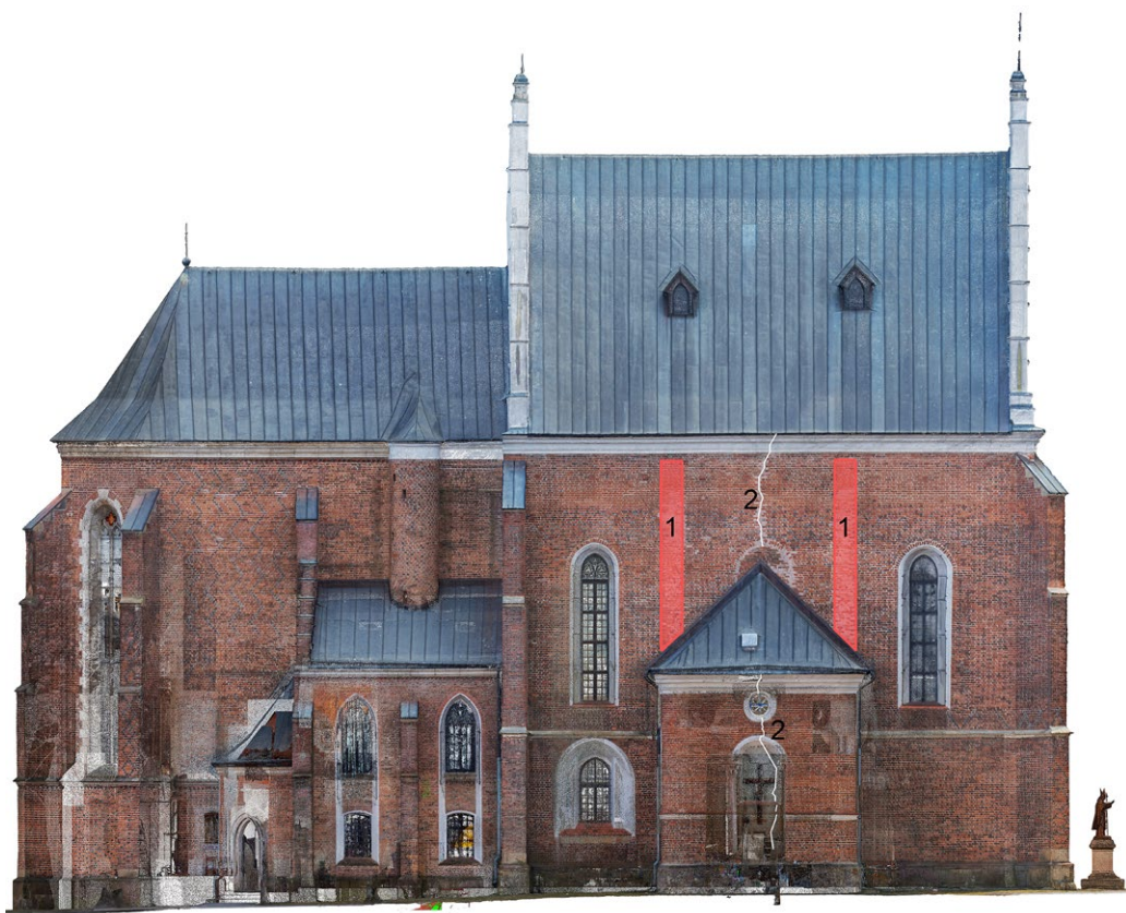
Ryc. 5. Elewacja północna kościoła w Drohobyczu z oznaczeniem przypór usuniętych podczas przebudowy barokowej (1) oraz spękań ścian i kaplicy północnej (2); 2023
